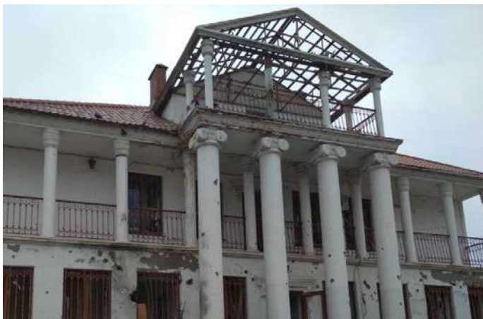
Зруйнована будівля Культурного центру Федерації грецьких товариств у Маріуполі Донецької області
