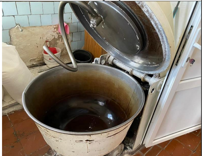
(Фото 20) Приміщення їдальні потребує ремонту
